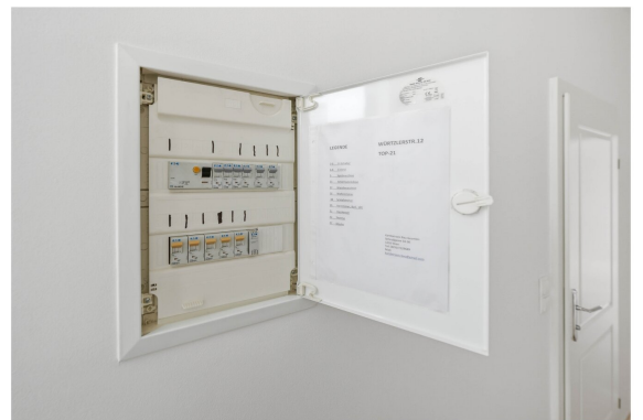
Elektro-Sicherungskasten Mit jeder Wohnung wird ein E-Befund übergeben
