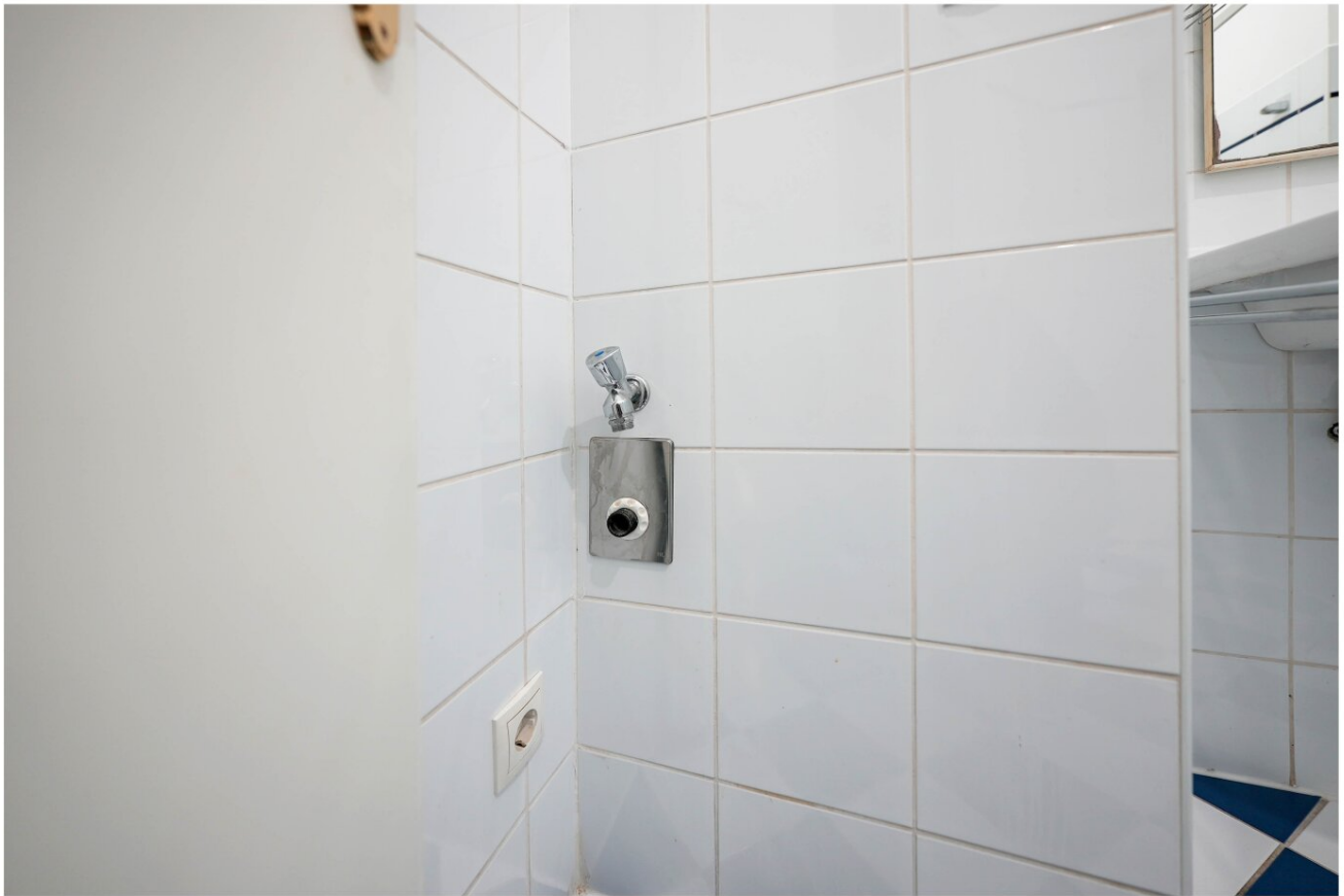
Waschmaschinenanschluss im Bad
