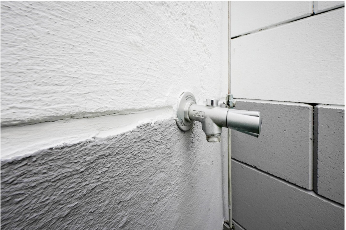
Wasserentnahmestelle (Kempervenil) auf der Terrasse
