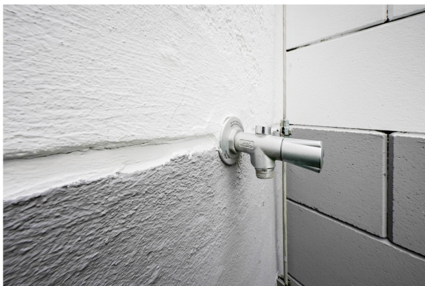
Wasserentnahmestelle (Kemperventil) auf der Terrasse
