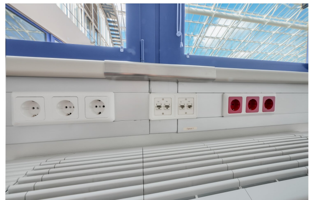
EDV Verkabelung CAT5e
