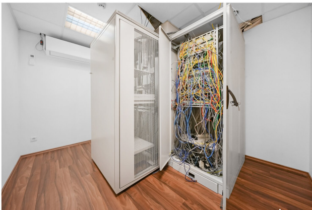
Serverraum mit Klima Splitgerät
