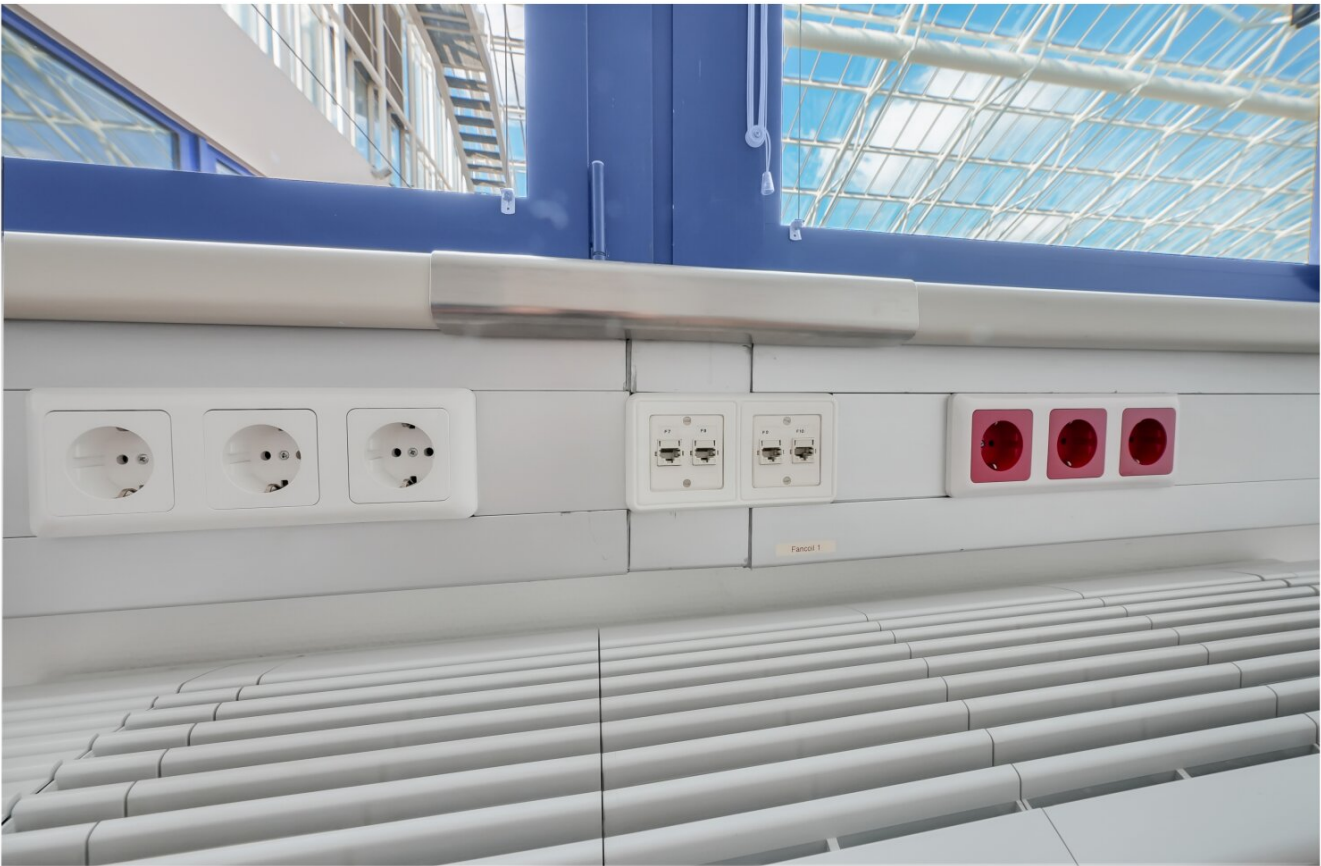
EDV Verkabelung CAT5e
