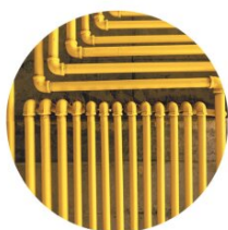
Erdwärme für Fussbodenheizung und Deckenkühlung
